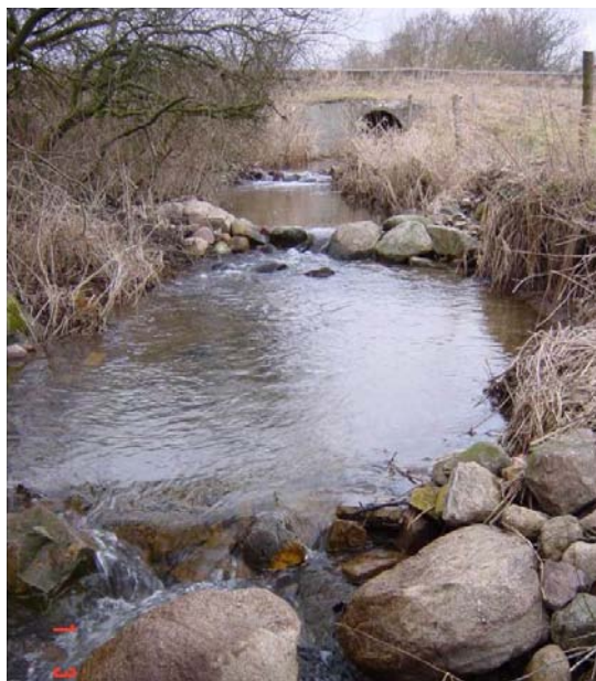
Rør under vej, hvor der tidligere var et styrt. Vandstanden er hævet ca. 30 cm for at skabe passage, men det er sket med håndsten. Hvis der i stedet havde været anvendt gydestryg til at stuve vandet op, kunne man have anlagt 6 gydebanker på hver 10 m.
