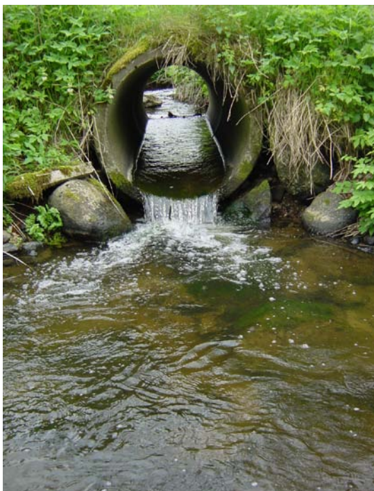
Rørstyrt under markvej, hvor fisk og fauna ikke kan passere opstrøms pga. et styrt ved udløbet og for lavt vand i røret.
