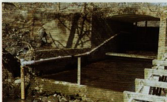
Ålepasset kan føres uden om stemmeværkets bevægelige dele, her er det monteret fast på betonvæggen.
