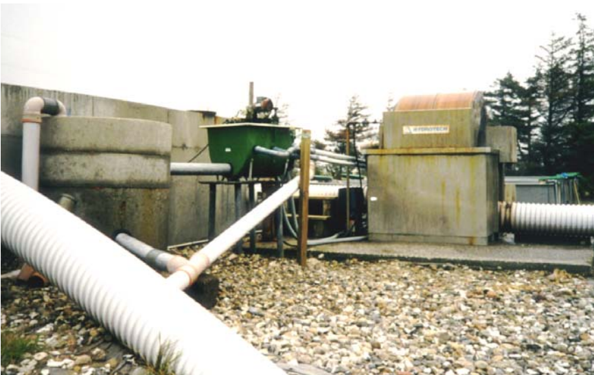
Figur 4.16. Filterstation. Tv. Rektangulært sandfang, i midten Unik-filter til filtrering af zooplankton (2 fraktioner) til/fra bassiner. Th. Hydrotech tromlefilter til filtrering af frisk havvand fra fjord.
