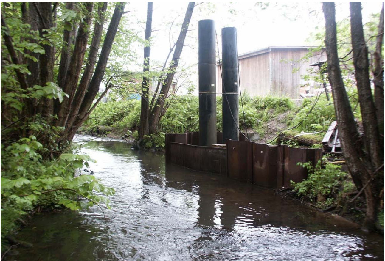
Vandindtaget til ørredslagteriet Danforel ved Højen Bæk, hvor virksomheden nu pumper sit vand ind i stedet for at lede det ind på virksomheden via en opstemning. Der er etableret et tæt gitter med 10 mm tremmeafstand foran vandindtaget (ved de lodrette rør), og returvandet løber ud igen umiddelbart nedstrøms vandindtaget (foto Jan Nielsen).
