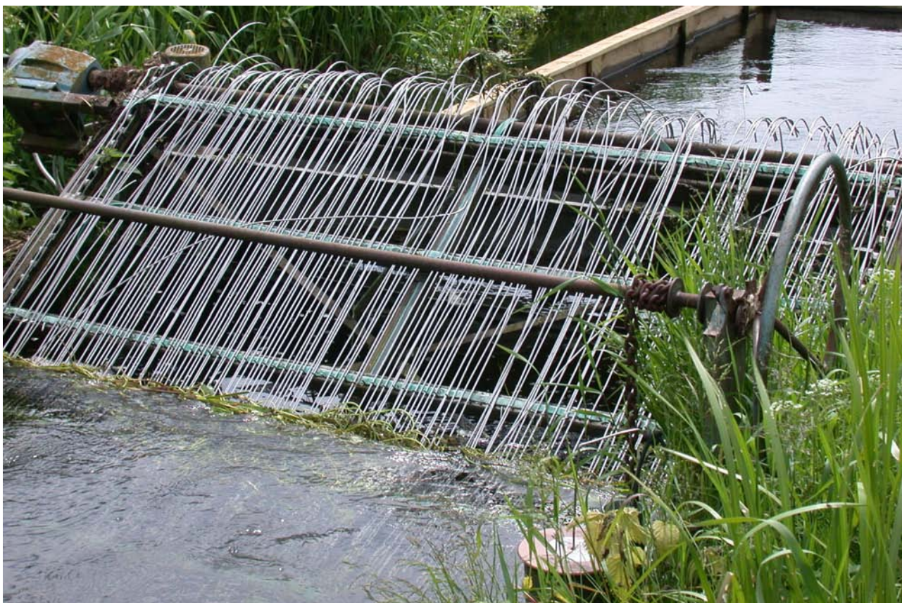
Automatisk risterenser i indløbet på et dambrug. Typen godkendes ofte som en afgitring i indløbet. Bemærk de fleksible gitter-tråde, der bevirker at kravet på 10 mm tremmeafstand ikke overholdes og at fisk kan trænge ind bag gitteret (foto Thorsten Olesen).
