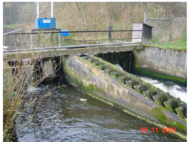
Opstemning med fisketrappe ved Vingsted Dam-brug i Vejle Å. Opstemningen var i mange år en delvis spærring for ørrederne til trods for der var etableret fisketrappe (foto Vejle Amt).
