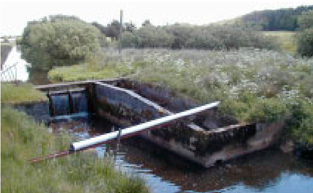
Utidssvarende fisketrappe med for lille vandføring. Trappen burde kunne føre al vand der ikke bruges til dambrugsdriften (Foto Michael Deacon).
